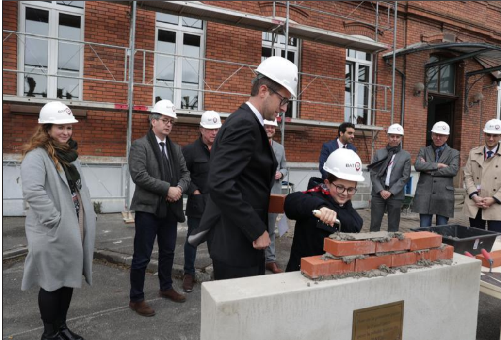
La pose de la première pierre, avant la réhabilitation du bâtiment 36, s'est déroulée le jeudi 7 mars. Mais les anciennes briques rouges posées en 1900 ne bougeront pas. Photo L'Alsace/Darek SZUSTER
